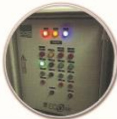
ชุดแผงควบคุม ปลอดภัย ควบคุมง่าย
